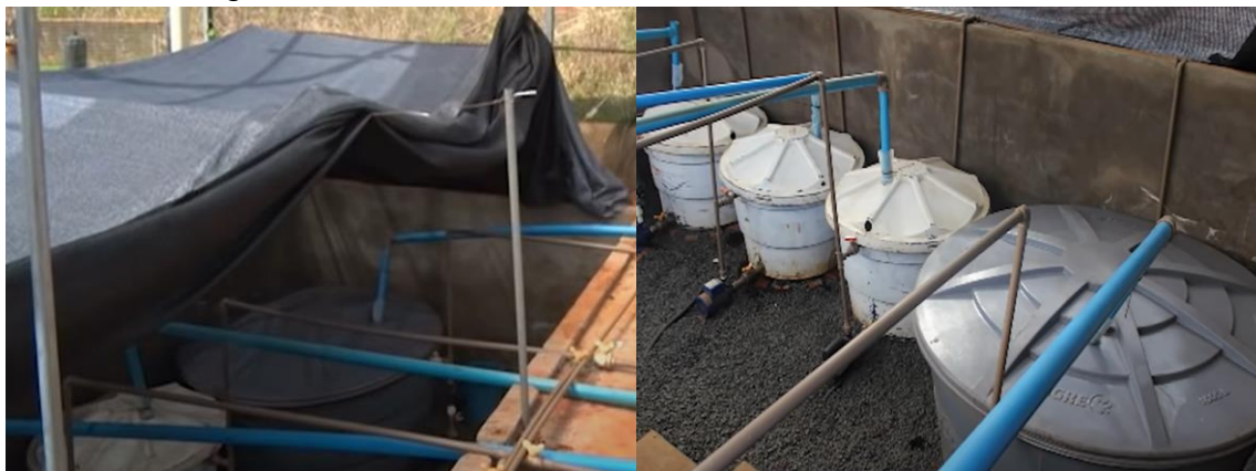
Figura 6. Reservatórios instalados abaixo do nível do solo.
